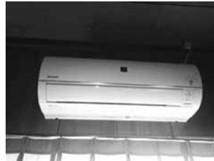
整備されたエアコン
