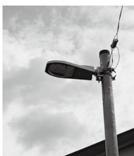
LED化された街路灯
