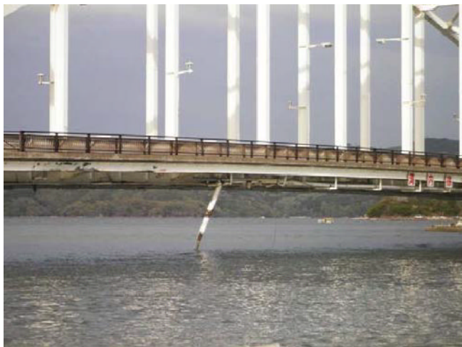
(参考) 地震により被災した橋梁添加管
