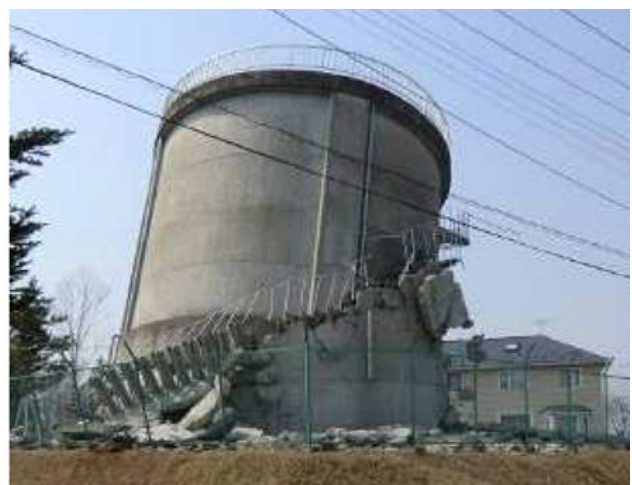
(参考) 地震により被災したPCタンク
