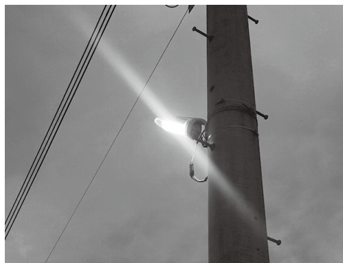
▲LEDを活用した防犯灯
