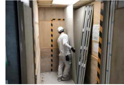
現場内の昇降機を荷物専用として運用
