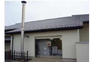
「街の駅やまなし」冷暖房ボイラー
