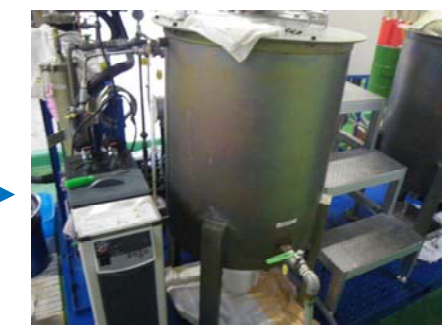
④精製・仕上げ 減圧下で加熱し残存するメタノール及び水を除去します。 次いで、吸着剤カラムとミクロンフィルターを透過させ、不純物除去します。 製品タンクで冷却します。
