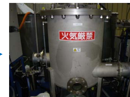
②前処理（反応タンク使用） 反応タンクで、脱酸・脱水の前処理をします。
